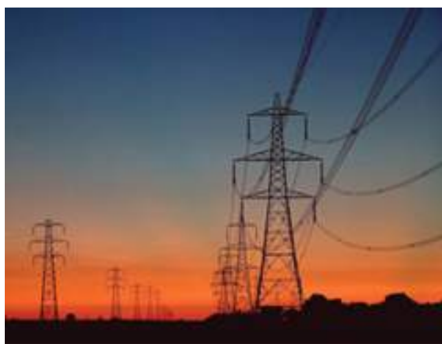
Fig. 2 – Transporte de energia elétrica
